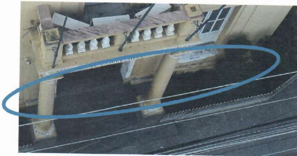
Imagem 09: Evidenciando a desagregação com descolamento do revestimento devido a infiltração de água e ou correlatos na fachada.
