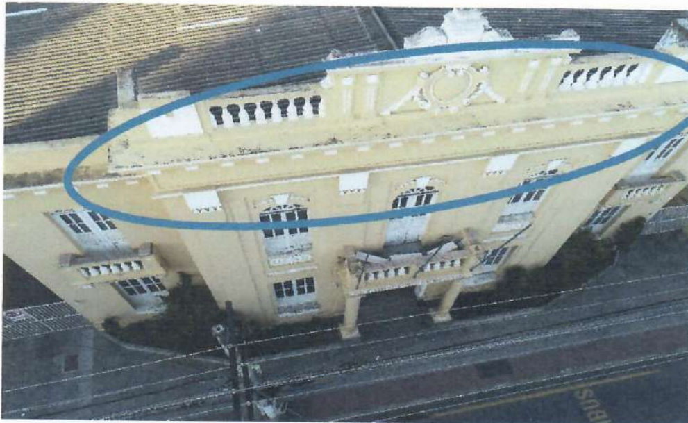
Figura 03: Imagens evidenciam a heterogeneidade do reboco presente na fachada.
