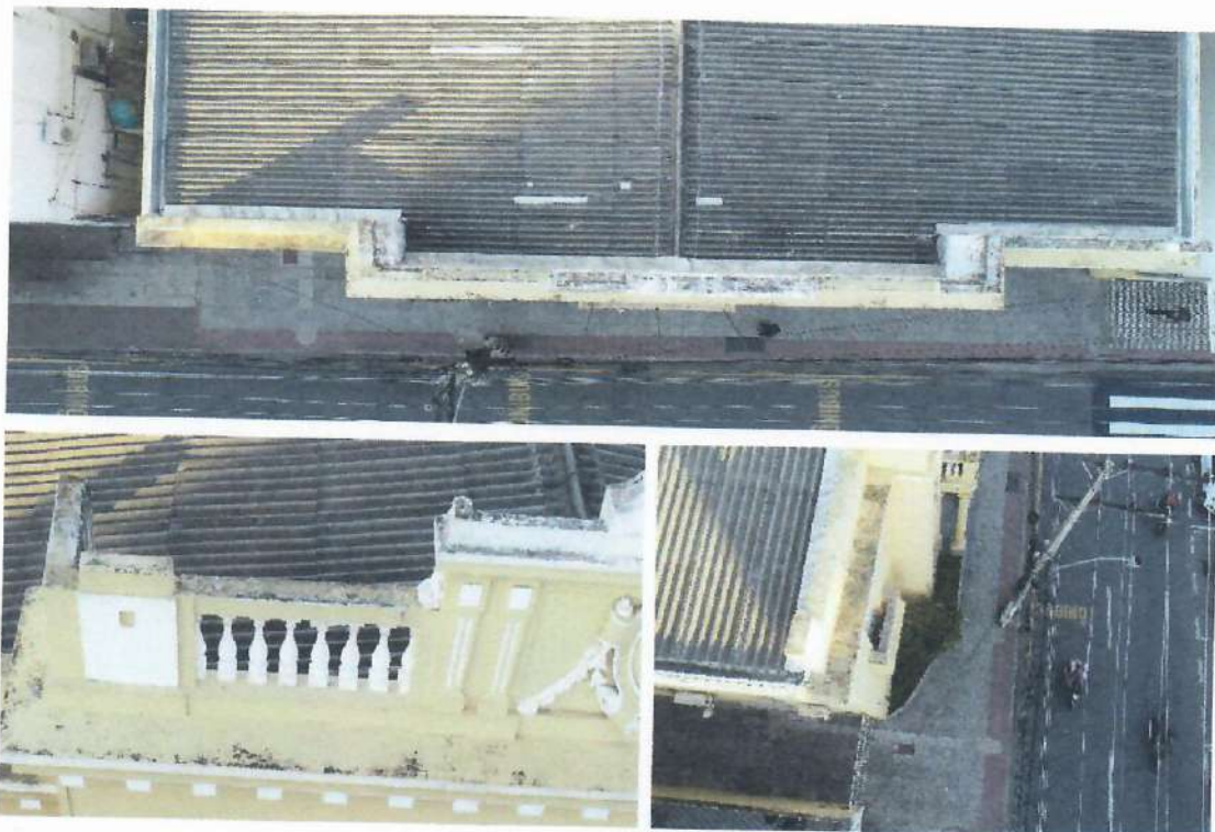
Imagens 10, 11 e 12: As manchas em preto evidenciam o Biofilme formado na fachada da Câmara Municipal de Colatina, a imagem ao centro mostram o ápice da bioterização do edifício, com manchas de coprólito de aves por toda a região.
