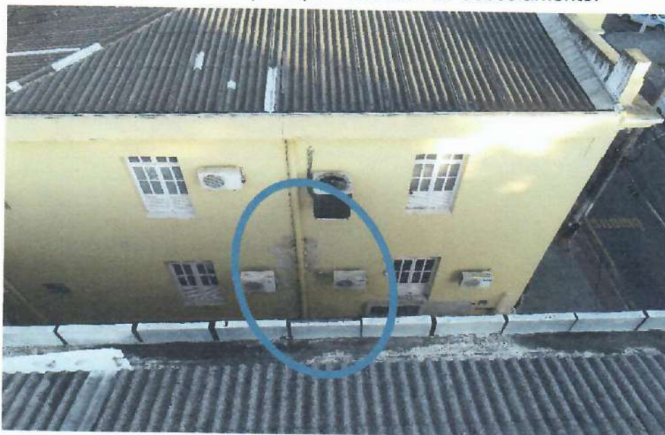
Imagem 07: No detalhe são amostrados o deslocamento de reboco, em ponto da fachada externa Câmara de Colatina.
